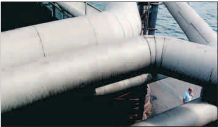
400 meter pipeline för in oljan i berggrummen från kajen.
