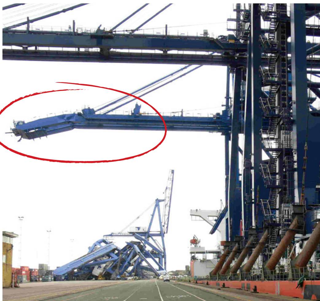
Oxelösunds Hamns nya kran, skadad i storm i Felixstowe, England.
